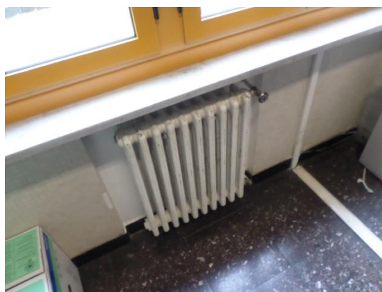
Figura 8.2 – Particolare radiatori attuali
