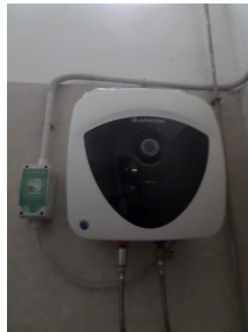
Figura 4.9 - Particolare del boiler elettrico per la produzione di acqua calda sanitaria]
