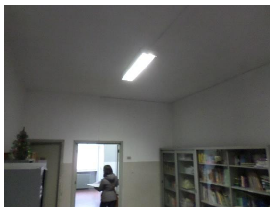
Figura 8.6 - Particolare dei corpi illuminanti attualmente installati
